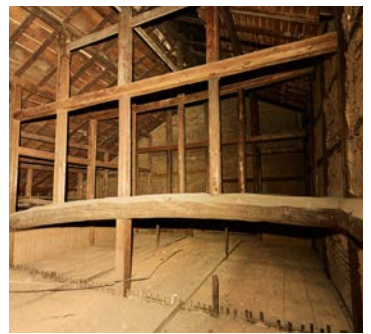
妙な束の長さから座敷を増築して屋根を上上げたことがわかりました。
